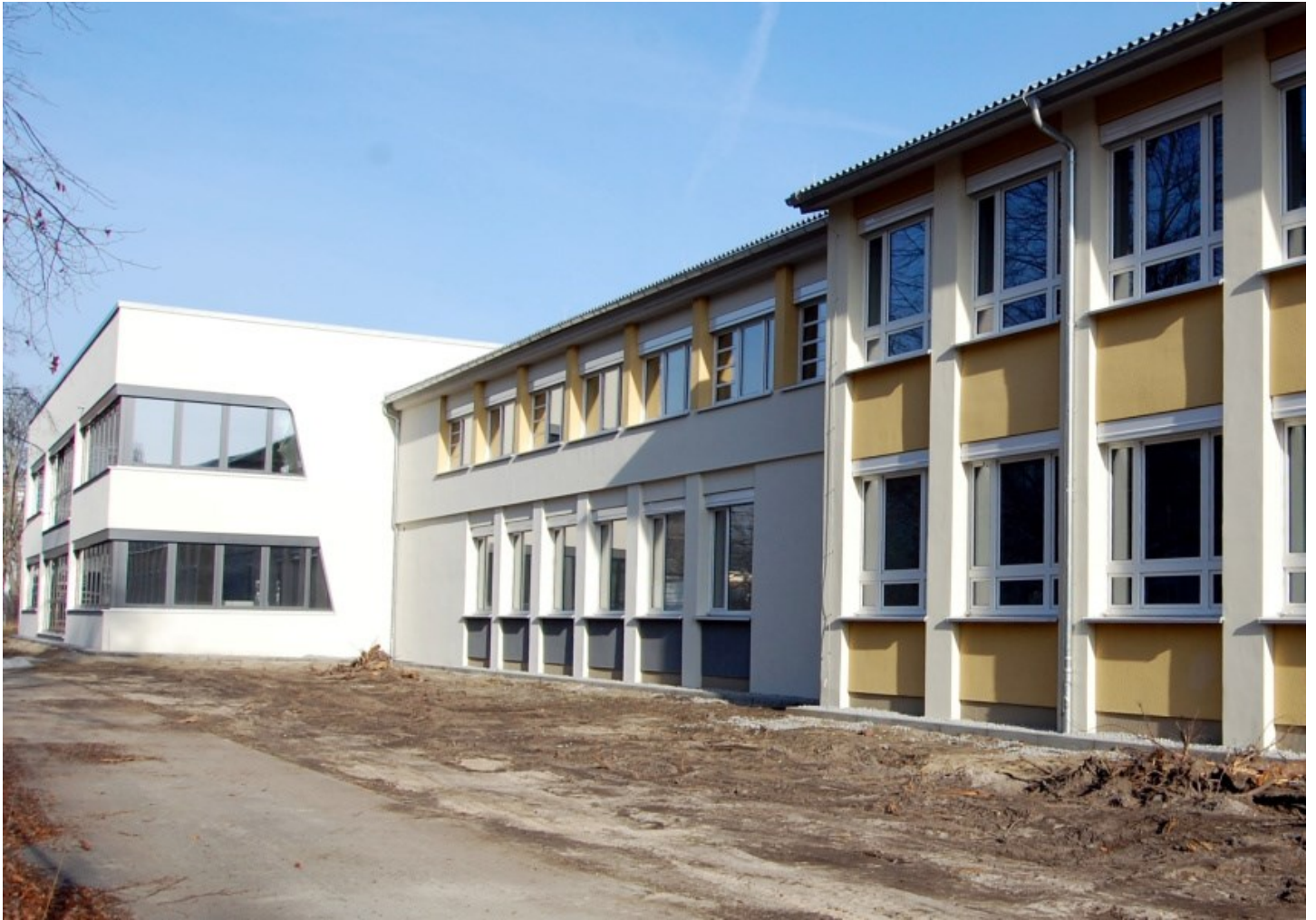
Im Sommer des Jahres 2000 schloss im WK I das Konrad-Zuse-Gymnasium. Vor drei Jahren begannen hier die Bauarbeiten an der künftigen Oberschule. Foto: Mirko Kolodziej
